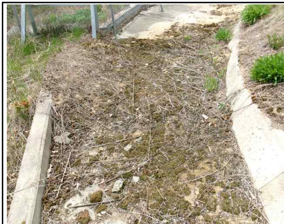
위 치 STA 2.24~2.51k 1소단배수로 현 황 토사 및 낙석퇴적
