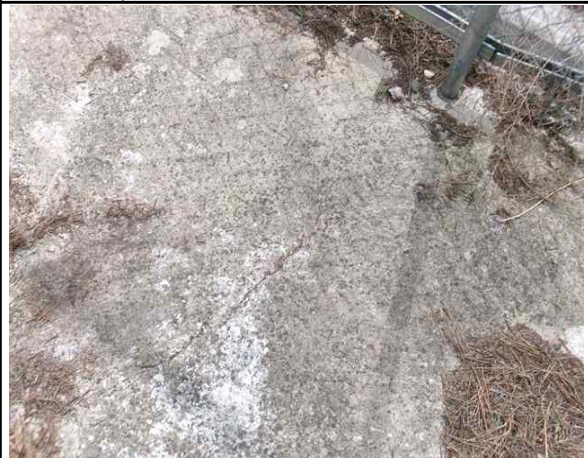
위 치 STA 2.36k 1소단배수로 현 황 균열 (L=2.0m)
