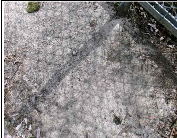
위 치 STA 2.40k 1소단배수로 현 황 균열 (L=2.0m)
